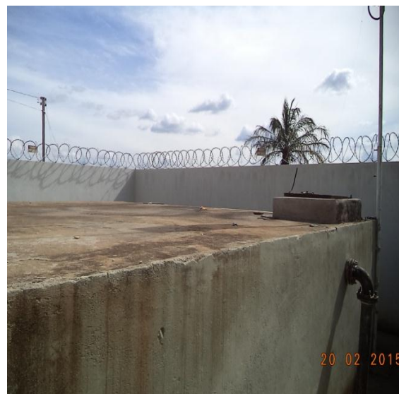
Figura 55: Reservatório (R4) Fonte: Prefeitura Prudente de Moraes, 2015.
