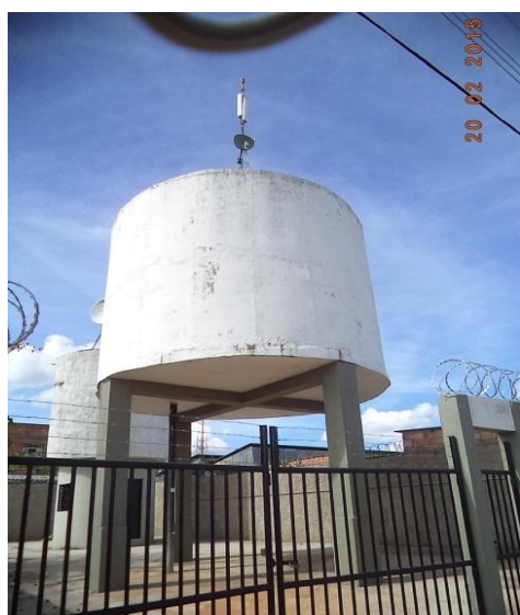
Figura 56: Reservatório (R5) Fonte: Prefeitura Prudente de Moraes, 2015.
