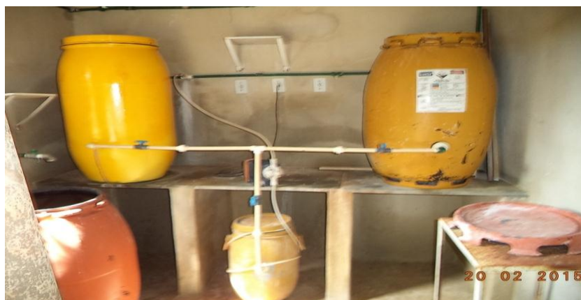
Figura 50: Sistema de tratamento de água do Poço Brejinho Fonte: Prefeitura Prudente de Morais, 2015.
