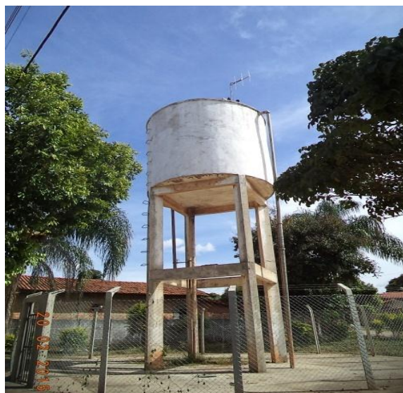
Figura 54: Reservatório (R3) Fonte: Prefeitura Prudente de Moraes, 2015.
