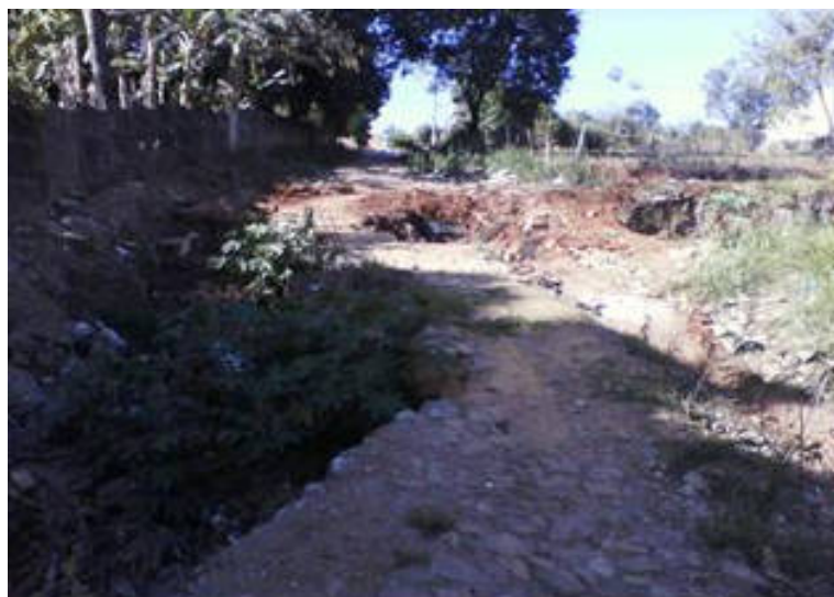
Figura 125: Erosão da Rua Fábio de Souza no bairro Emília Fonte: Prefeitura Prudente de Morais
