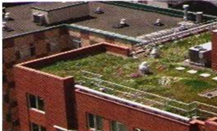
Figura 66: Telhado reservatório / telhado verde
