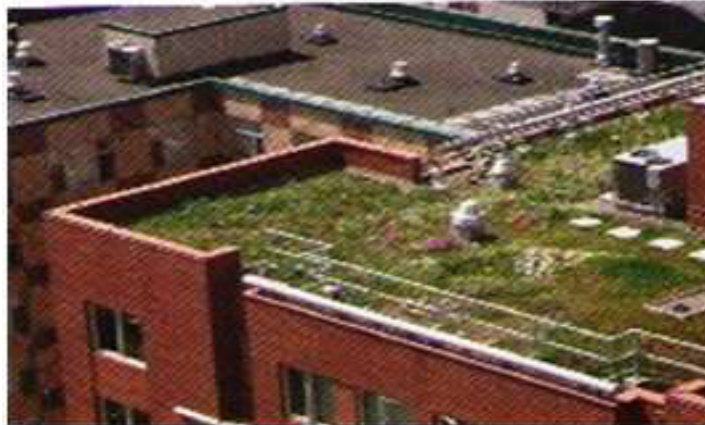
Figura 66: Telhado reservatório / telhado verde
