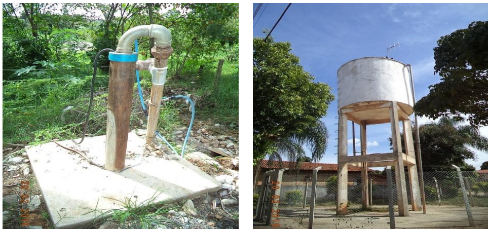
Figura 6: Poço e reservatório
